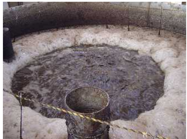
悪い状態の時の曝気槽 発泡が多く、泡に粘り気が出てきます。
